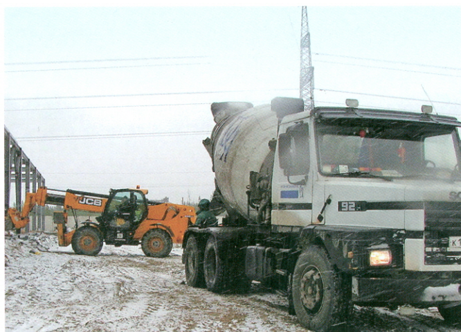
Рис. 10. Дальняя доставка бетона на стройплощадку РП 330 кВ «Путкинский» автомобилем SCANIA-92 (объем 6 м 3 ) с выгрузкой бетона в ковш телескопического погрузчика JCB 540-170, стрела 12 м («ЗАО «Энергострой», Карелия, 2012)
