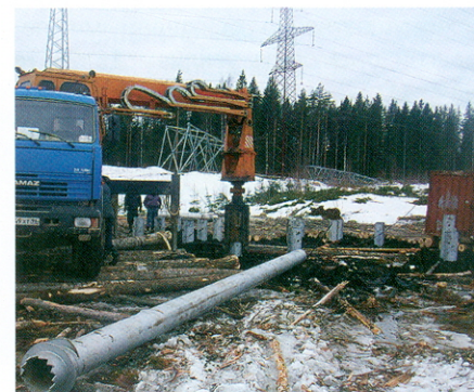
Рис. 16. Универсальная бурильная машина УБМ-85 на завинчивании полых винтовых свай СВМ на заходах ВЛ 110–330 кВ на ПС 330/110 кВ «Зеленогорск» (ЗАО «Энергострой» и ООО «Завод винтовых свай», Ленобласть, 2011)
