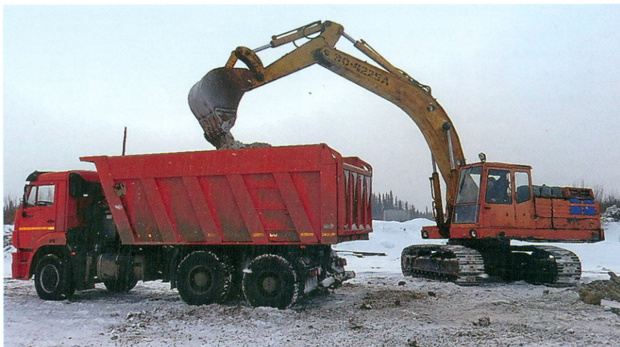
Рис. 13. Отечественный гусеничный экскаватор ЭО-4225А-7и самосвал КАМАЗ 6522-6011-43 с кузовом 16 м 3 с вездеходной колесной формулой 6×6 с обгоном платформы (ОАО «Глобалэлектросервис», начало работ на строительстве перехода ВЛ 220 кВ через Печору, март 2014)
