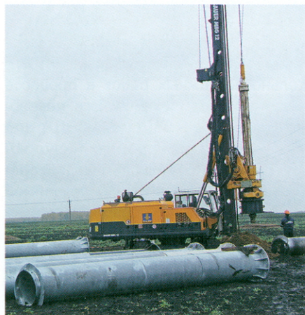
Рис. 7. Свая-оболочка ФВС диаметром 0,72 и длиной 5,5 м с лопастью, обеспечивающей винтовое погружение и анкеровку в грунтах, погруженная за 16 минут универсальной буровой машиной BAUER MBG-12 (ФРГ) для диаметра до 1,3 м с M_{крп} = 125 кНм (ОАО «СевЗап НТЦ», Урал, 2011)
