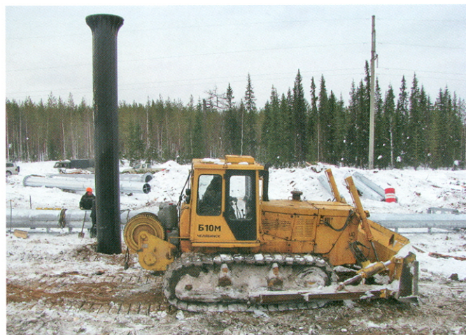
Рис. 11. Челябинский бульдозер Б10М с отвалом и лебедкой на снегоуборке и планировочных работах при строительстве ВЛ 220 кВ «Печорская ГРЭС – Ухта – Микунь» (ООО «Кировская мехколонна № 24», Республика Коми, 2013)
