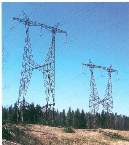
Рис. 2. Промежуточные опоры «Сви́рского типа» в Ленинградской области на действующих ВЛ 220 кВ МЭС Северо-Запада (1930)
