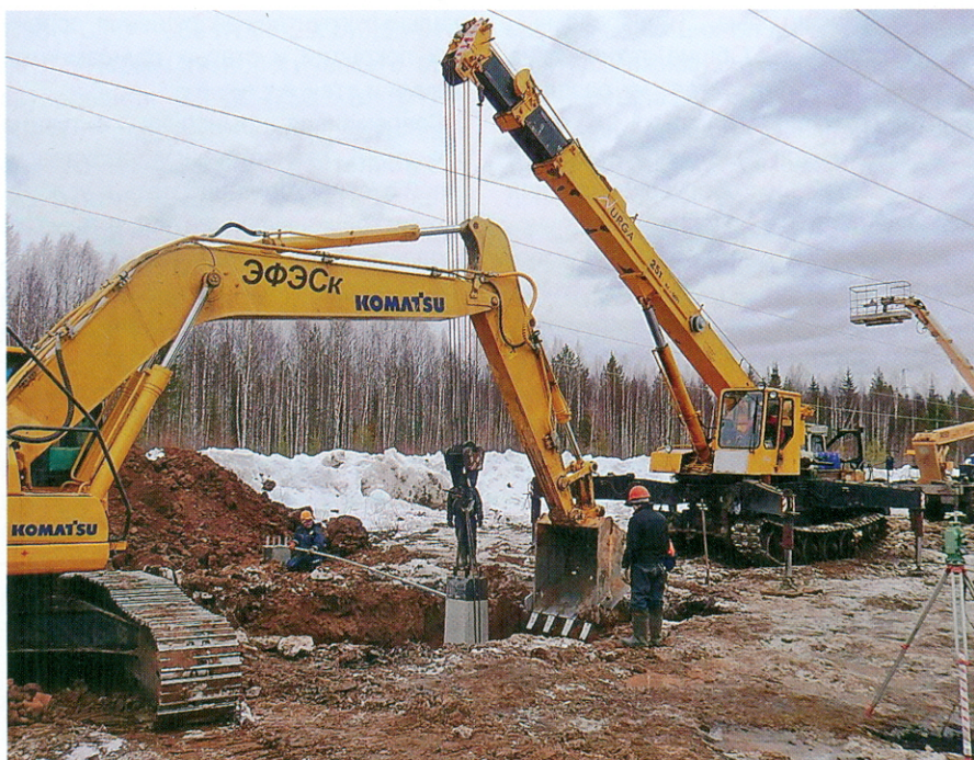
Рис. 14. Разработка малых котлованов под каждый фундамент вместо одного общего котлована под фундамент ФБ-4 механизированным звеном на гусеничном ходу «экскаватор + кран» без опасного спуска персонала в котлован (ЗАО «ЭФЭСк» на заходах ВЛ 220 кВ на ПС Микунь, 2014)
