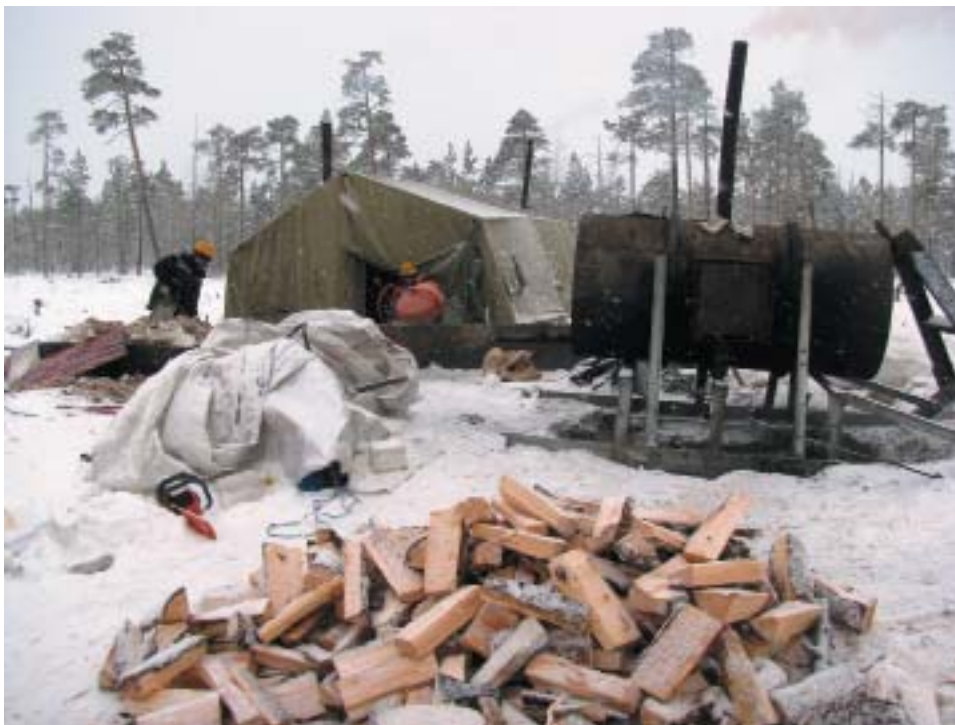
Рис. 4. Отапливаемый «тепляк» («know-how» от ЗАО «ЭФЭСк») для приготовления бетонной смеси, закрывающий строительную площадку в зимний период для сооружения монолитных скальных фундаментов опор ВЛ 330 кВ в северной Карелии (Кемь, 02.2012)
