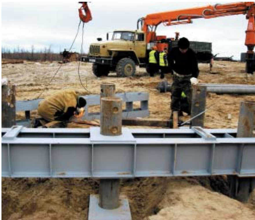
Рис. 11. Недопустимые газорезные работы при устройстве сварных ростверков на шестисвайных фундаментах по причине несоблюдения допусков по отклонениям осей свай от проектных по горизонтали (Новый Уренгой, 06.2007)
