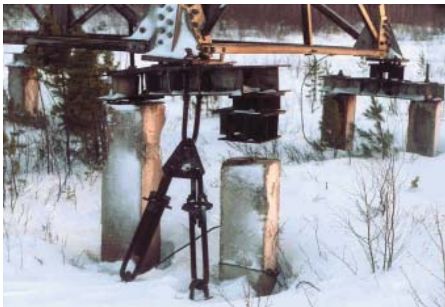
Рис. 1. Недопустимое опирание анкерно-угловой опоры ВЛ 220 кВ на фундаменты по причине потери заделки железобетонных свай в морозопучинистом основании и их неравномерном выпучивании (на переднем плане: специальное анкерующее устройство разработки ОАО «Институт Энергосетьпроект» [4]; фото: 10.2003)
