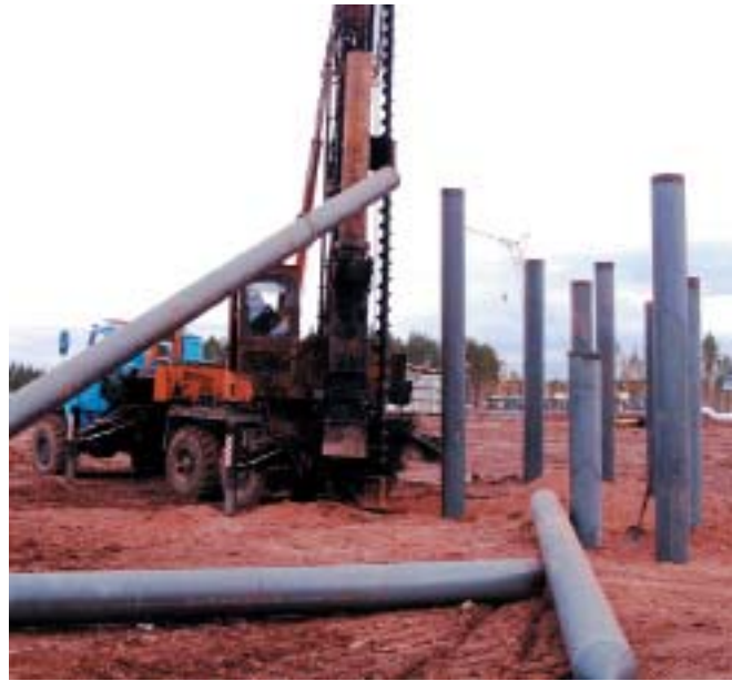
Рис. 8. Бурильно-сваебойная машина БМ-811М: бурение лидерных скважин диаметрами 150-400мм и копровая забивка стальных труб-свай (500 шт.) диаметрами 168–426 мм с конусными наконечниками на глубину 6-11м в выветрелые аргиллиты при обустройстве Дулисьминского месторождения (север Иркутской области, фото: 11.2010)
