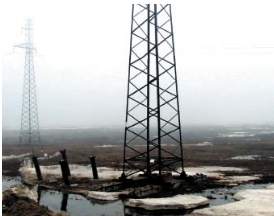
Рис. 2. Промежуточная опора П110-3, переставленная на поверхностные фундаменты по причине аварийного состояния стальных фундаментов из трубчатых свай, потерявших устойчивость из-за морозного выпучивания и открытой внутренней полости (Новый Уренгой, 2007)
